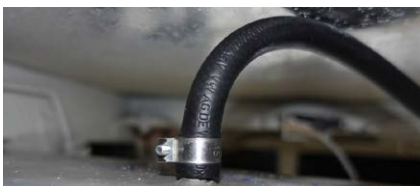
Entlüftungsschlauch \varnothing 10 mm angeschlossen
