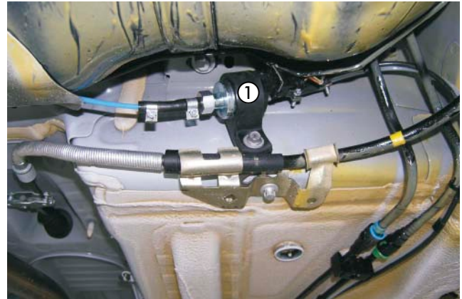
Abb. 33 ① Dosierpumpe, montiert
